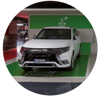
Station de recharge pour véhicule électrique
